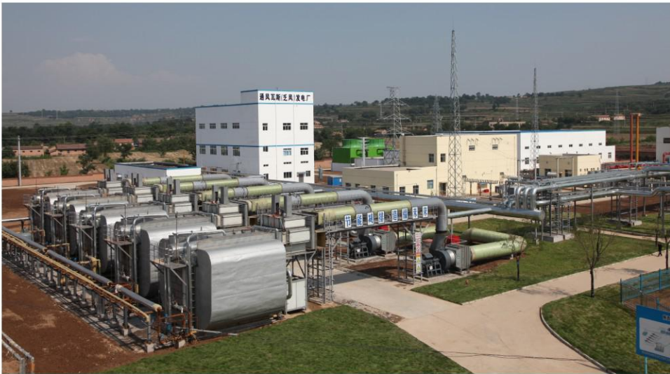
彬长矿业公司大佛寺煤矿通风瓦斯（乏风）发电厂
