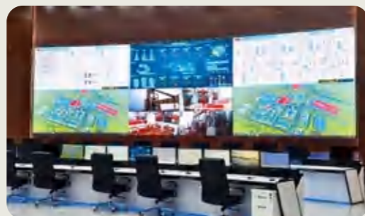
3800m 3 高炉集控中心工位图
