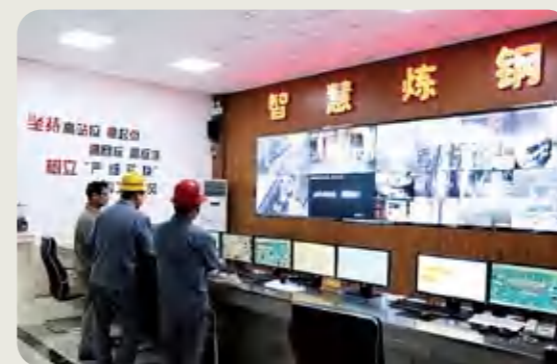
山东钢铁构建智能化本质安全型工厂
