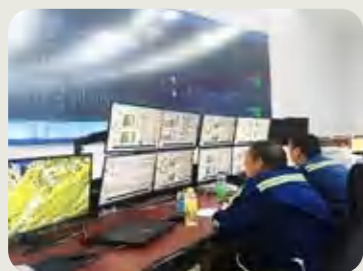
煤气集控中心
